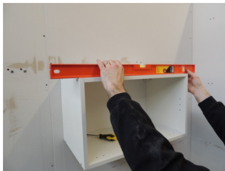
Contrôle du niveau (c)
